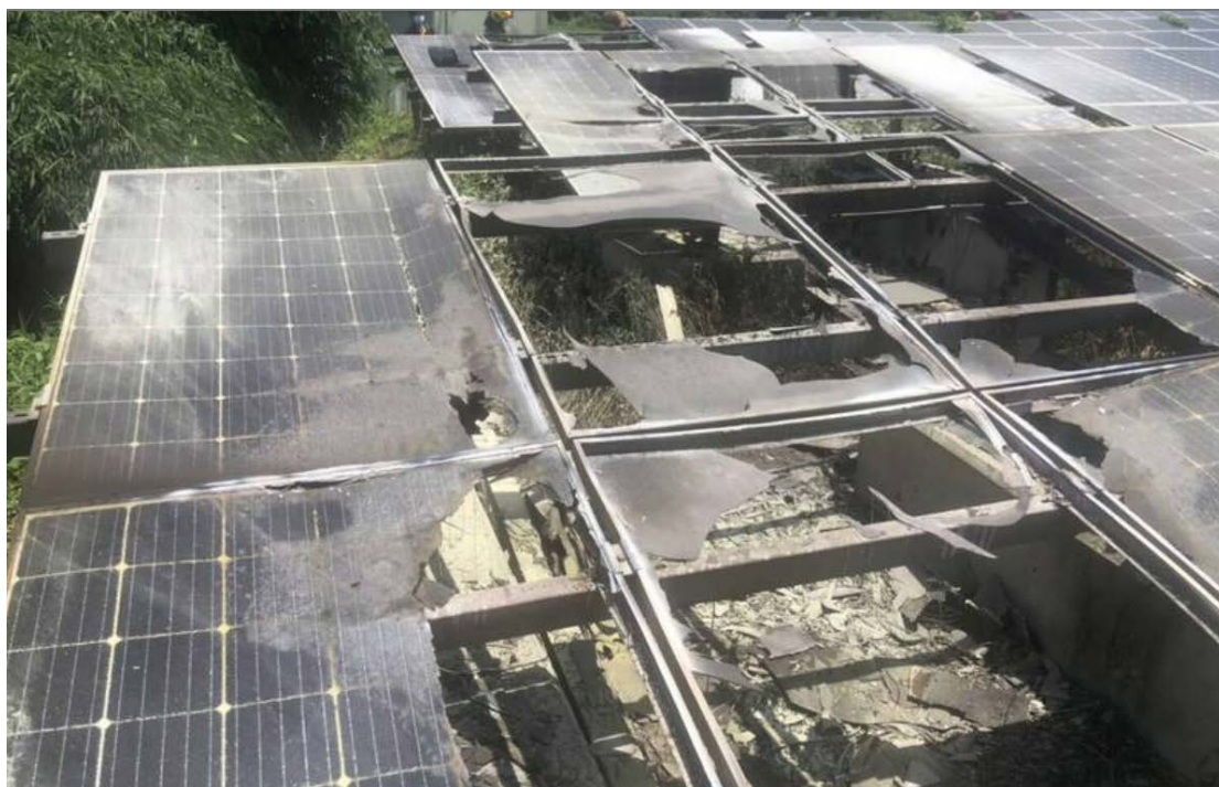
（台南太陽能電板除草作業引發火災）
